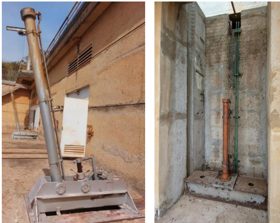
Figure 17: Vérins des vannes segment (à gauche) et de la vanne wagon (à droite)
