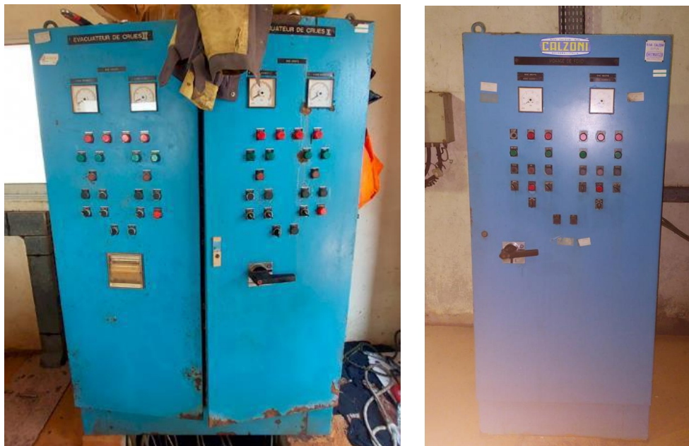
Figure 12: Armoires électriques vanne de surface (à gauche) et vanne de fond (à droite)
