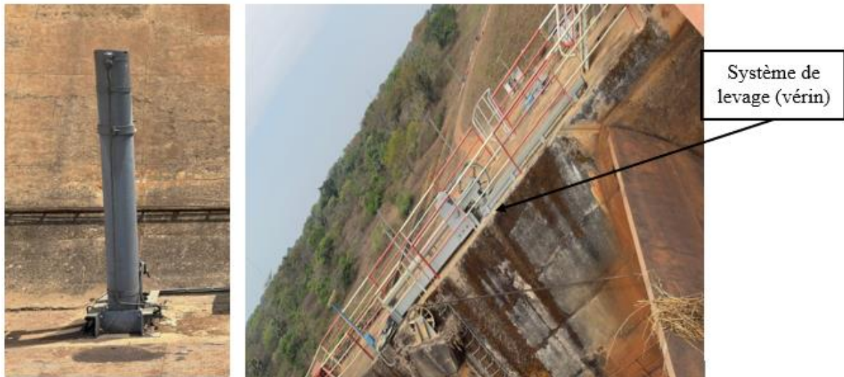
Figure 4: Systèmes de levage de la vanne de fond (à gauche) et de la vanne de surface (à droite)
