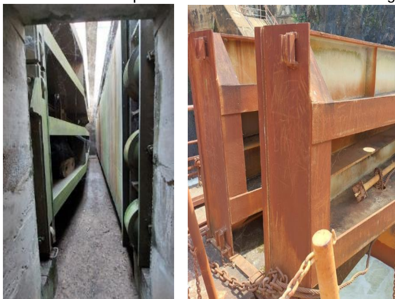
Figure 13: Éléments de batardeau amont (à gauche) et aval (à droite)
