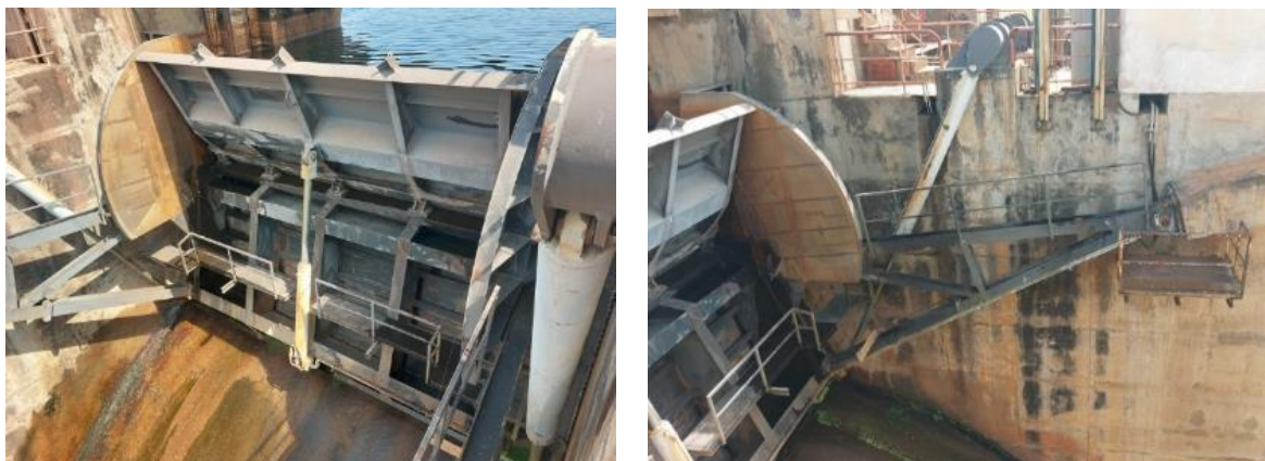
Figure 9: État vanne de surface
